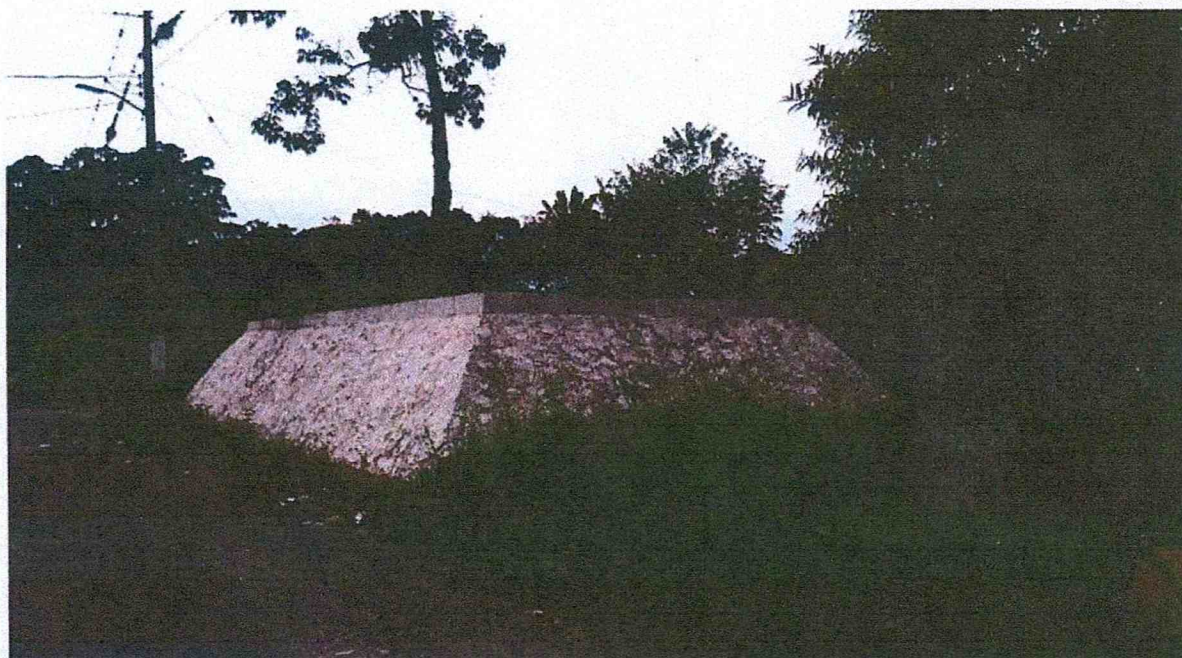
CAJA DE AGUA DECUAHUTEMOC H012
